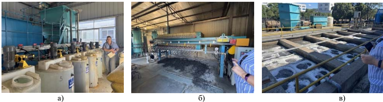
Рис. 1. Дільниця очищення води машинобудівного підприємства: а) приміщення реагентного очищення води; б) шнекові преси для збору твердої фази відходів; в) система мулових танків.
