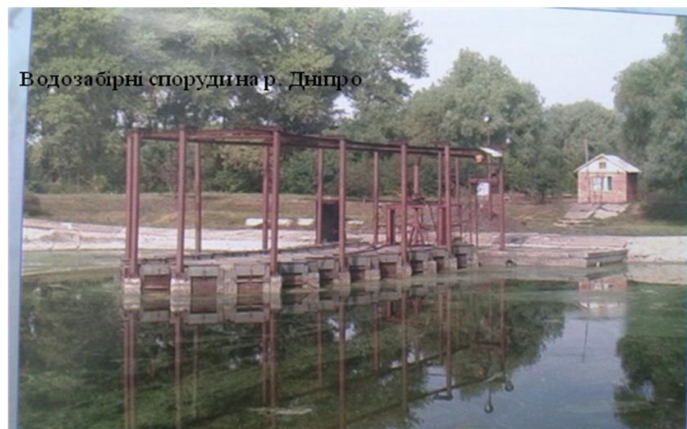
Рис. 1.15. Водозабірні споруди на р. Дніпро у с. Микільське Херсонської області (фото з відкритих джерел).
